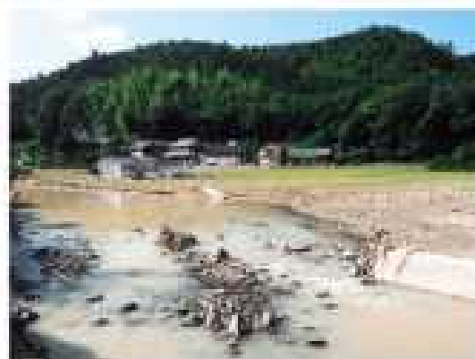
堤防が決壊した小海川(北谷下)
