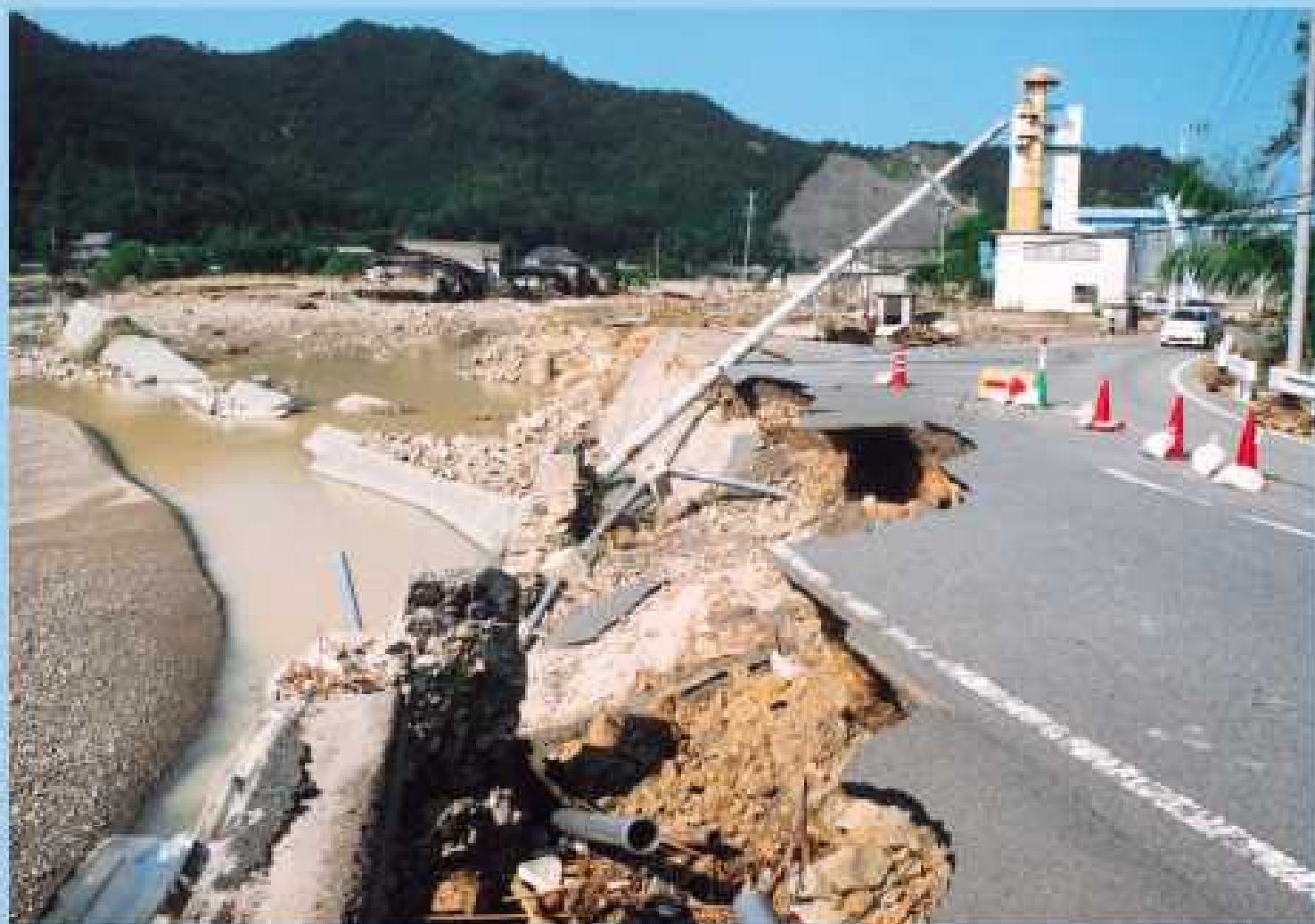
■白鳥地区の市道空堀馬目崎線 —溪川と支流の合流点で道路が大きくえぐられた—
