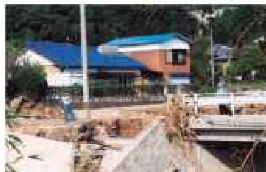
災害見舞いに訪れた人と陥没した道路を挟んで (森菰地区)
