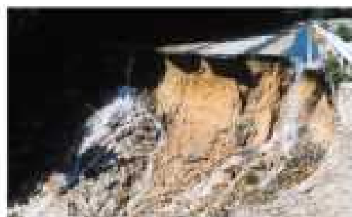
県道2号線崩落 山から流れ出る水が滝のように流れ落ちる(目下地区)
