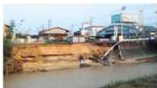
与田川沿いの道路が流失(川東地区)
