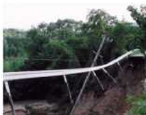
道路が流失し、香川用水の管が寸断される(榎松地区)
