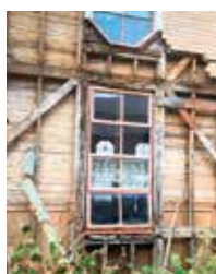
登録有形文化財に指定されている引田の古い街並みのシンボリック建物「旧引田郵便局舎の外壁崩壊状況」
