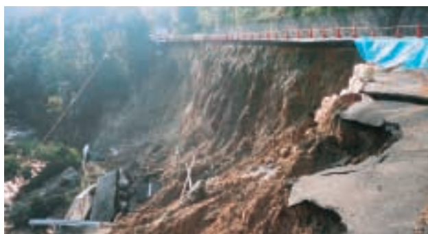
▲国道377号線崩壊（上末国地区）
