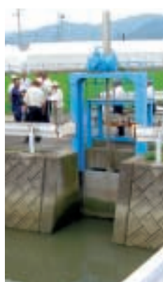
横内ポンプ場
