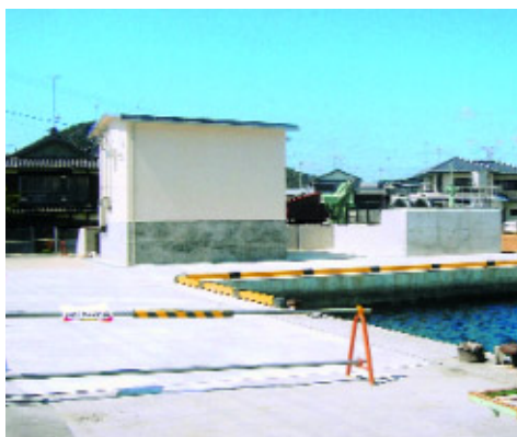
新設された川向排水機場
