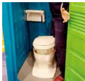
マンホールトイレ
