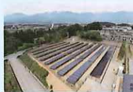
リユース品を使用した発電所
