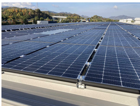
※本社工場に設置した太陽光発電システム
